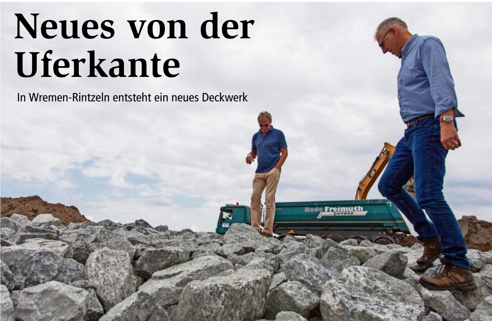
Deichverbandsgeschäftsführer Thomas Ströer (rechts) und Oberdeichgräfe Günter Veldmann sind zufrieden mit den Fortschritten der Baustelle. Die Wasserbausteine werden noch mit Spezialbeton befestigt und sollen das Ufer vor weiteren Abbrüchen schützen. Fotos: (3) Leuschner
