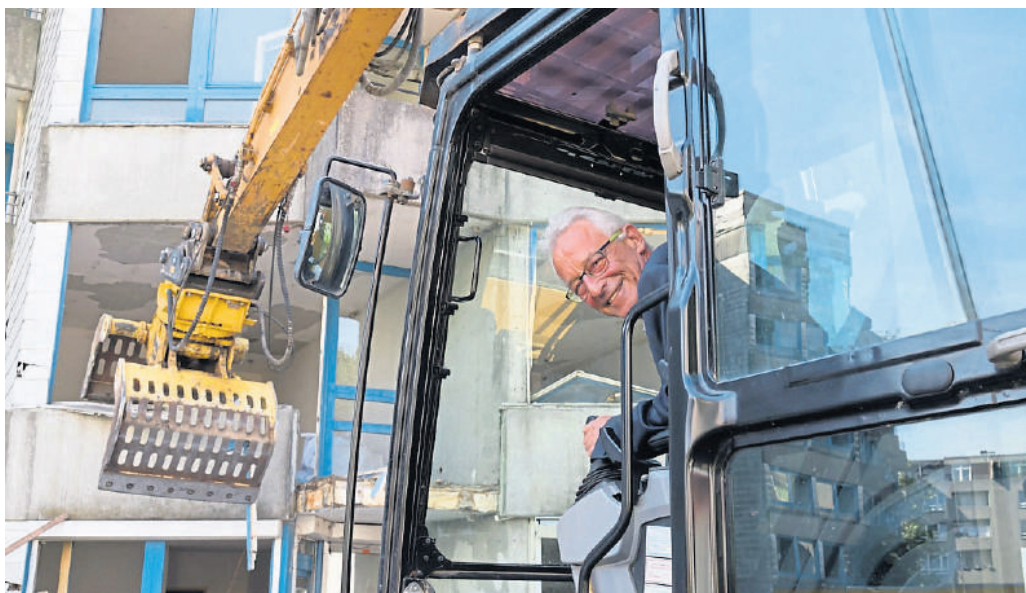
Oberbürgermeister Axel Jahnz im Bagger: Der Abriss eines weiteren Wohnblocks beginnt. FOTO: HOHMANN
