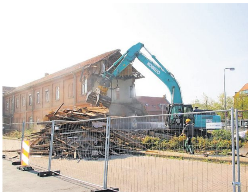
Vor dem Abriss des alten Bahnhofs hat die Stadt Cuxhaven den Gedenkstein für die Eisenbahner in Sicherheit gebracht. Es wird auf dem Bauhof zwischengelagert. Nach dem Umbau soll er einen Ehrenplatz erhalten.
